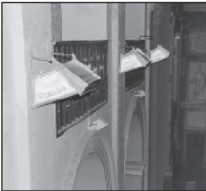
La instal·lació consta de vuit pantalles
