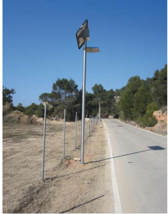
FANALS SOLARS A L'ENTRADA DEL BARRI DE LES GARRIGUES
