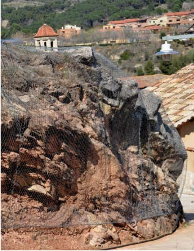
PROTECCIÓ QUE S'HA COL·LOCAT A LA MUNTANYA DEL CAMÍ DEL CASTELL
